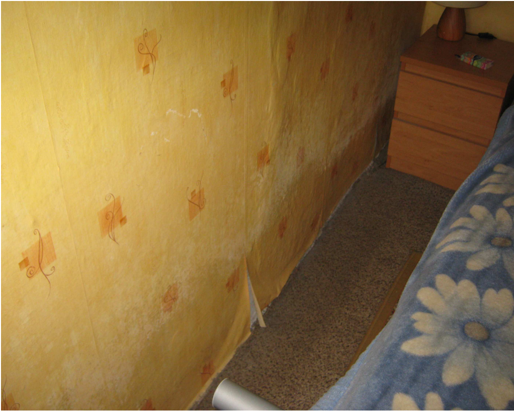
Foto 5 – widoczna pleśń w mieszkaniu nr 1
