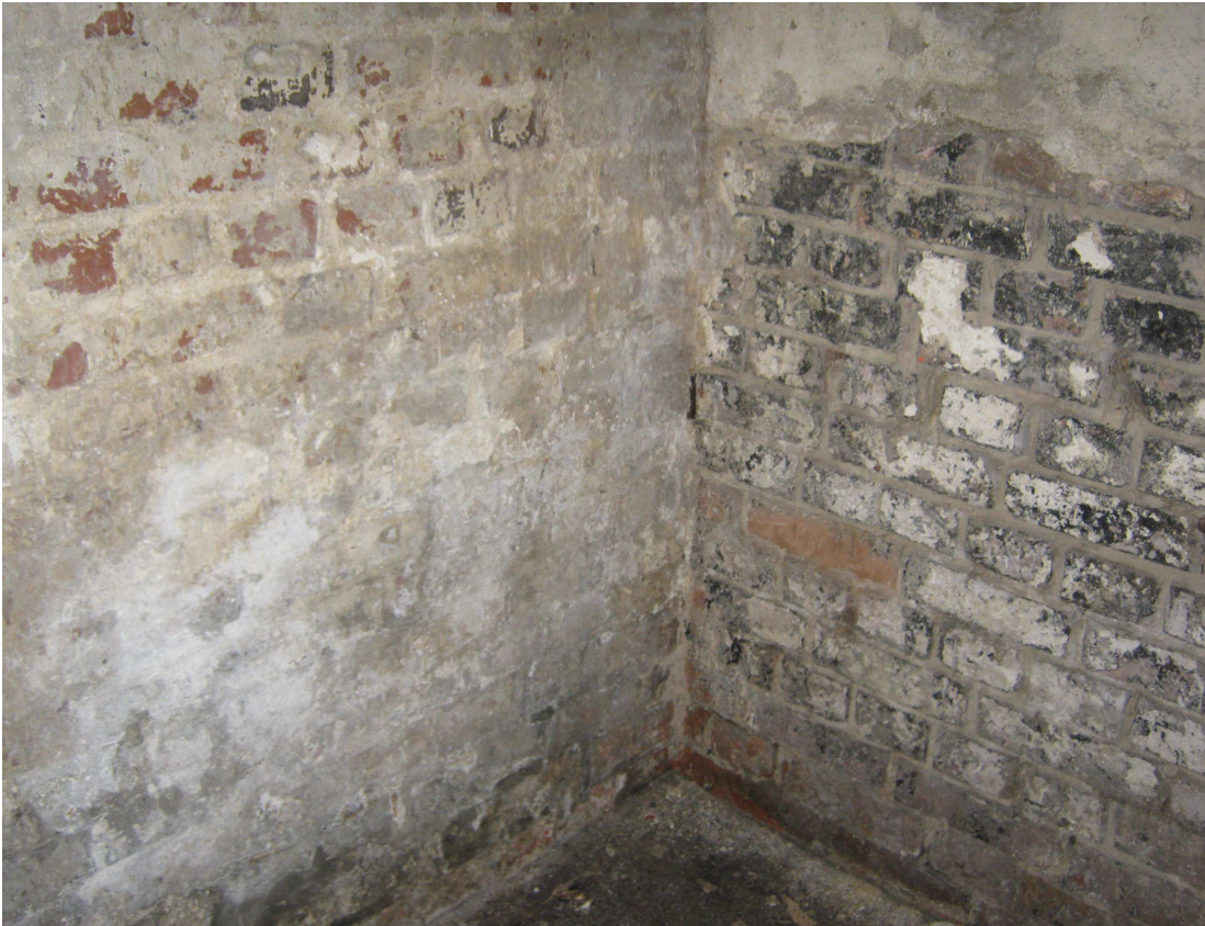
Foto 13– widoczne ubytki tynku i wilgoć na ścianach w piwnicy
