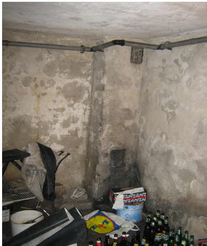
Foto 14– widoczna wilgoć na ścianach i trzonie kominowym w piwnicy
