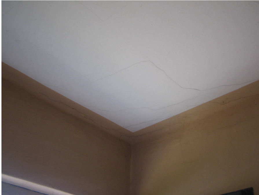
Foto 7 – widoczne pęknięcia sufitu w stropie nad parterem w pomieszczeniu korytarza w lokalu użytkowym U1
