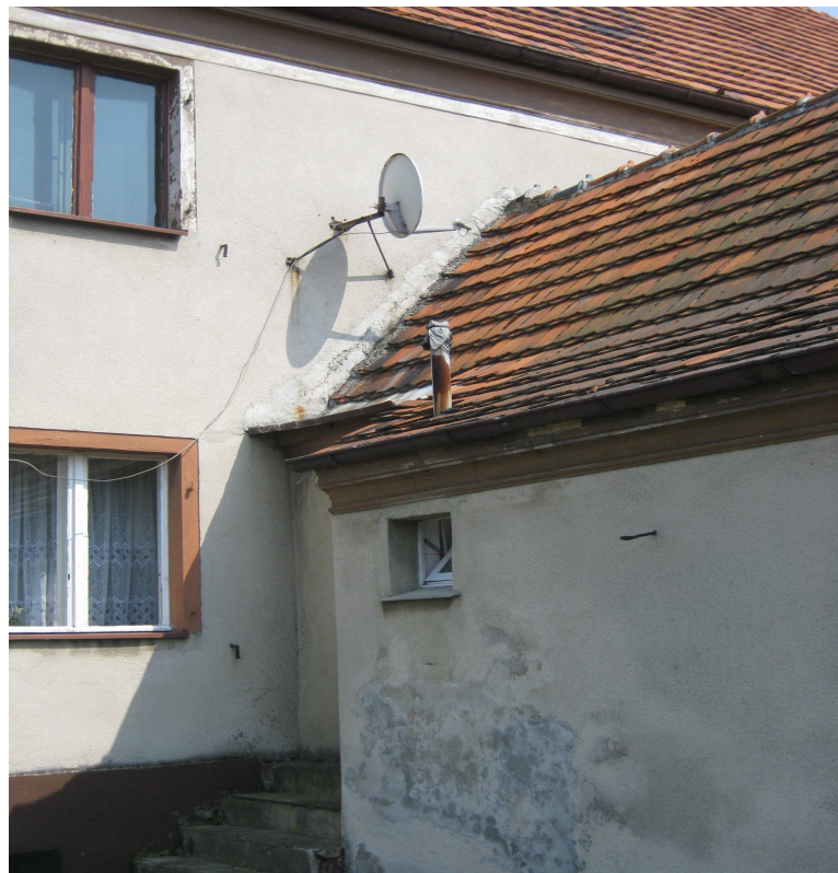
Foto 16– widoczna wilgoć na ścianie dobudówki
