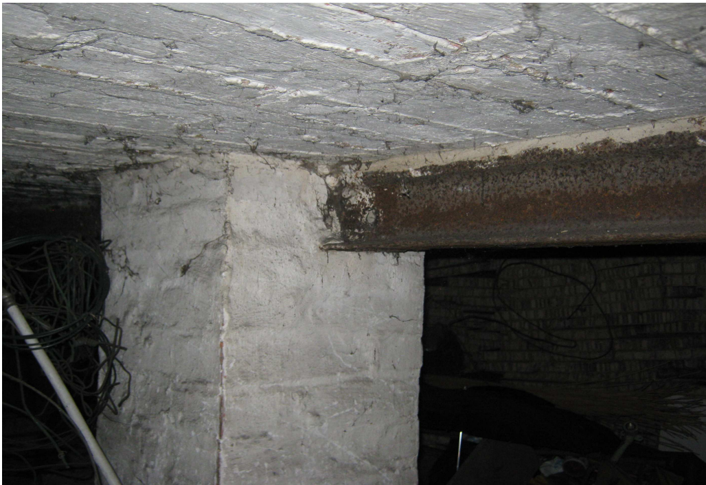
Foto 12– widoczna korozja belek stopowych w piwnicach
