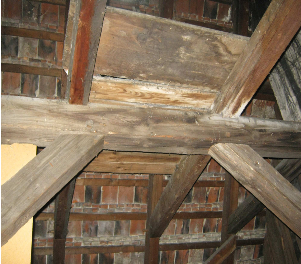
Foto 1 - zalanie więźby dachowej
