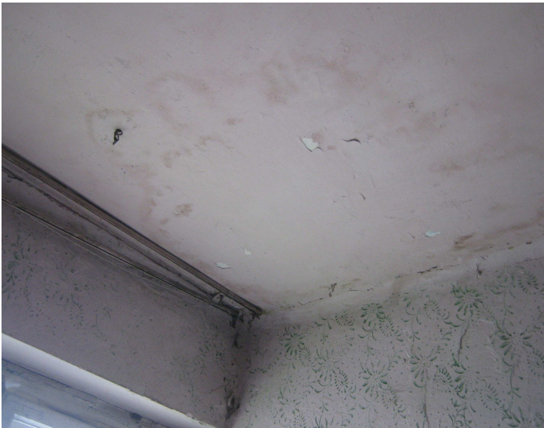
Foto 4 – widoczne zalanie stropu nad I piętrzem w lokalu mieszkaniowym nr 2
