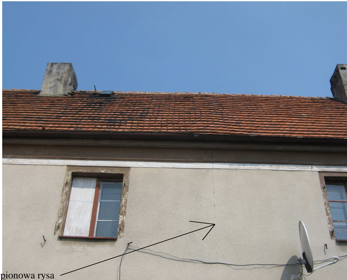
Foto 15– widoczne pęknięcia ściany zewnętrznej – elewacja tylna
