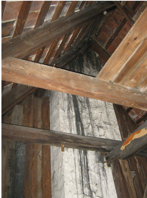
Foto 2 – widoczne zalanie trzon kominowy na poddaszu
