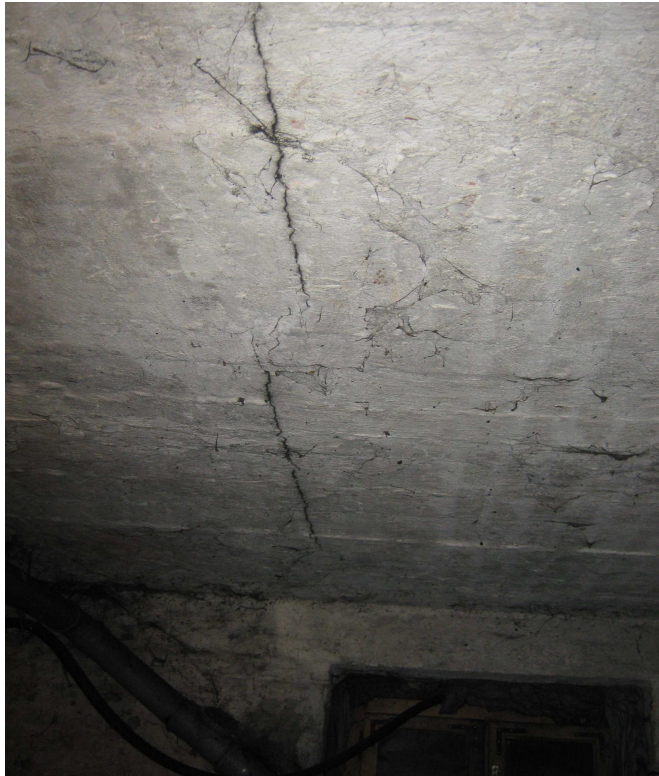
Foto 11– widoczne pęknięcie stropu nad piwnica w piwnicy rzymależnej do lokalu nr 4
