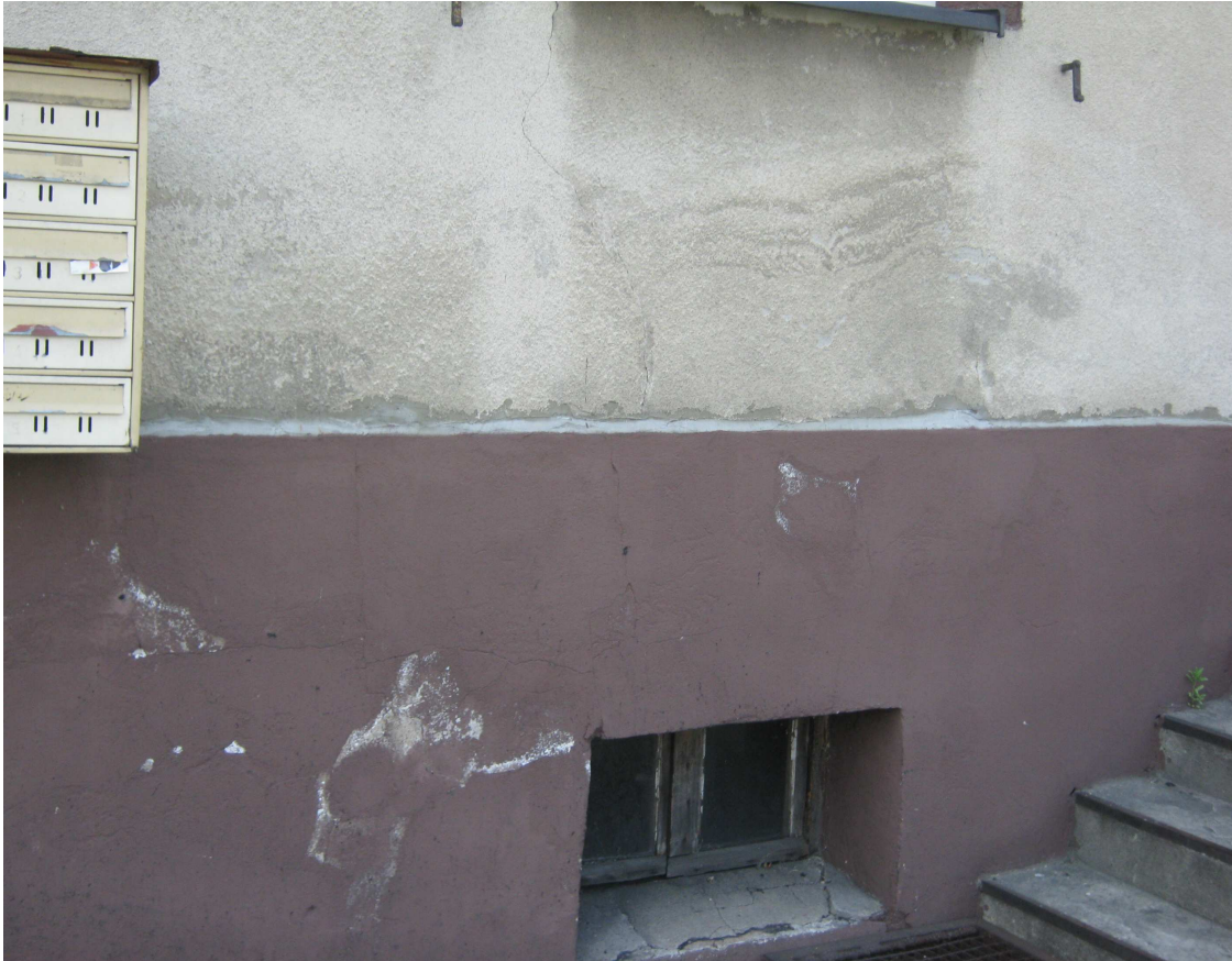
Foto 17– widoczna wilgoć rysa podmiędzy oknami – elewacja frontowa
