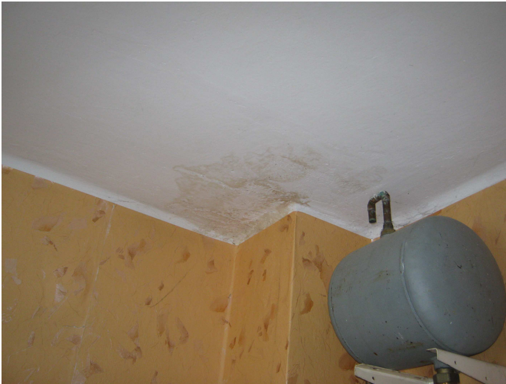
Foto 3 – widoczne zalanie stropu nad I piętrzem przy trzonie kominowym w lokalu mieszkaniowym nr 4
