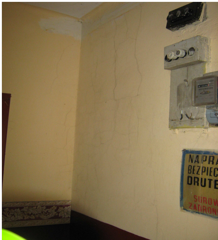
Foto 10 – widoczne pęknięcie ściany w korytarz na parterze w klatce schodowej nr 4
