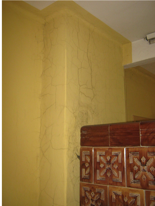
Foto 6 – spękany trzon kominowy w pomieszczeniu użytkowym lokalu U1
