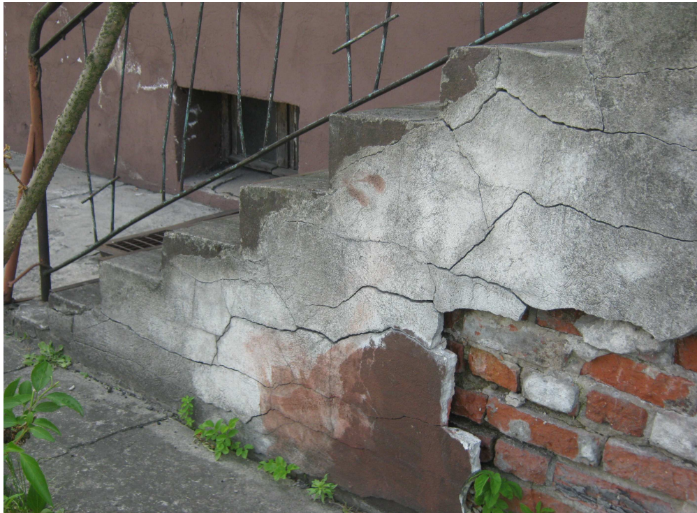
Foto 18– widoczne pęknięcia na bocznych ściankach schodów zewnętrznych, braki tynków
