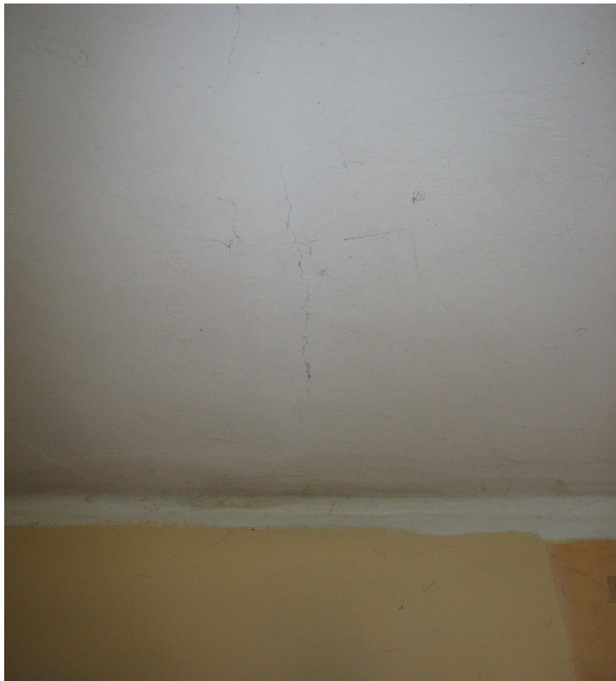
Foto 8 – widoczne pęknięcia sufitu w stropie nad parterem w pomieszczeniu pokój nr 1 w lokalu nr 3
