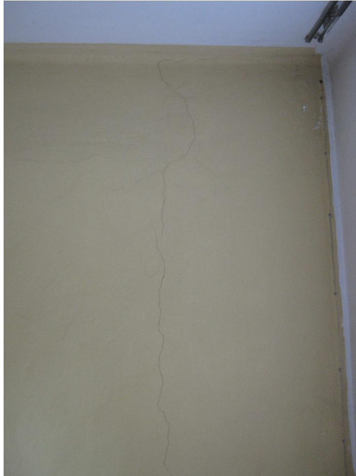
Foto 9 – widoczne pęknięcie ściany w pomieszczeniu użytkowym w lokalu użytkowym U1
